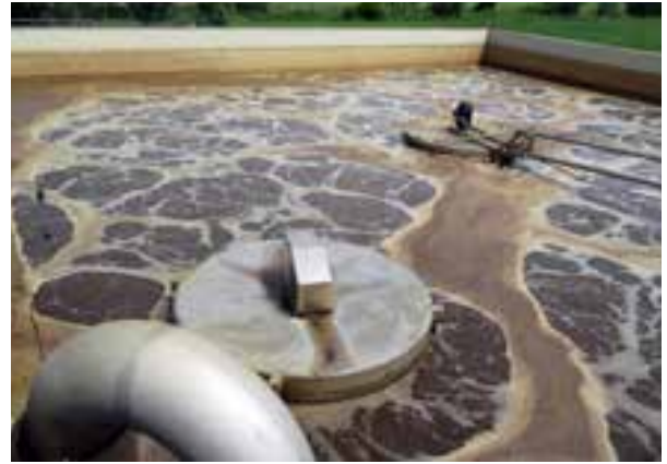
Biologische Reinigung (Belüftungsbecken)
